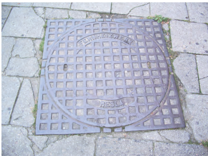
1. Żeliwna płyta kanału przy ul. Dawida 1
